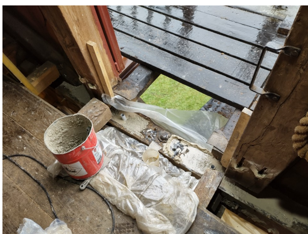
De met epoxyhars opgevulde achterzomer. Links en rechts van de deurposten zijn de buisjes te zien waardoor de metalen staven gaan waarmee de zomerbalk gekoppeld wordt aan de lange burriebalken (voegburries)
