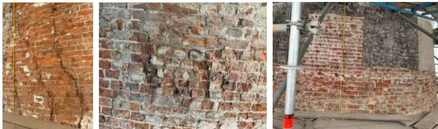
Onthullingen na verwijdering van stucwerk. Links: scheuren van de brand uit 1904. Midden: Resten van een granaatinslag van september 1944. Rechts: de overgang naar een andere steensoort op 8 m hoogte boven de belt.
